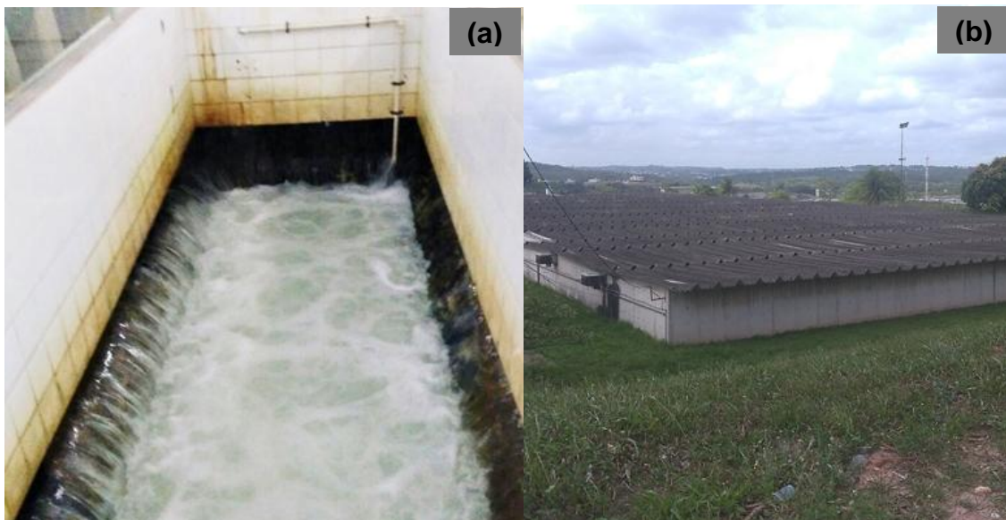
Figura 25 - Câmara de desinfecção em operação (a); Reservatórios semi- apoiados (b).
