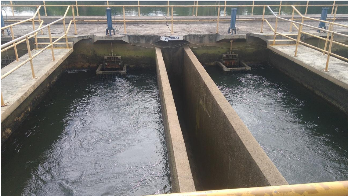
Figura 24 - Filtros em operação.
