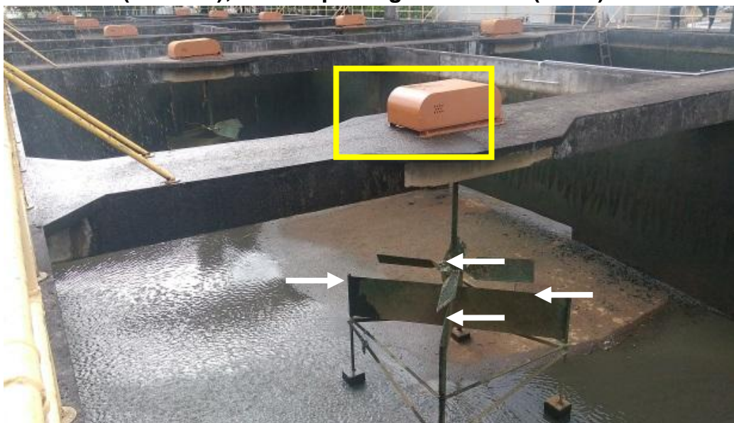
Figura 20 - Floculador mecânico de eixo vertical. no momento em que a câmara de floculação foi esvaziada para limpeza. Motor de acionamento de rotor (amarelo); hélices para agitar o fluido (setas).
