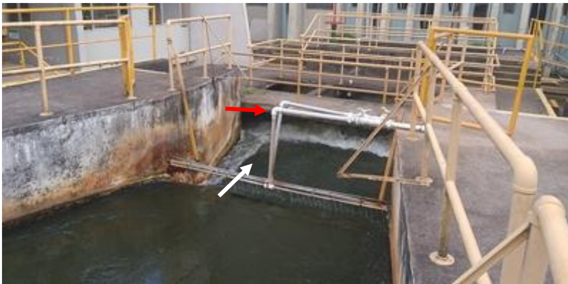
Figura 18 - Medição de vazão e mistura rápida na calha Parshall. Adição de coagulante (seta vermelha); sentido da água (seta branca).
