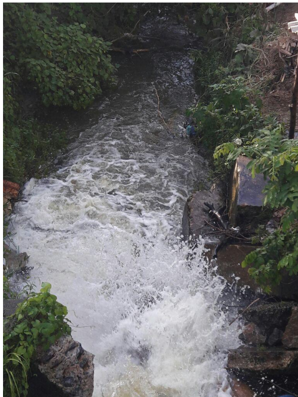
Figura 37 - Vista superior da saída de lodo da lavagem dos filtros da ETA.
