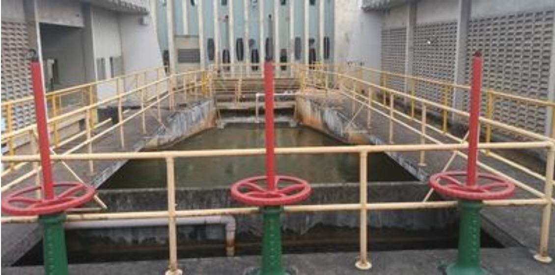
Figura 17 - Chegada de água bruta na ETA Castello Branco.
