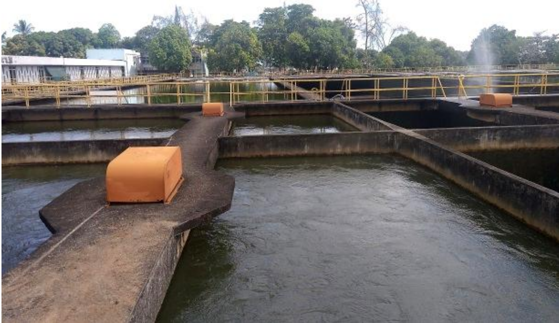
Figura 19 - Floculador em operação.
