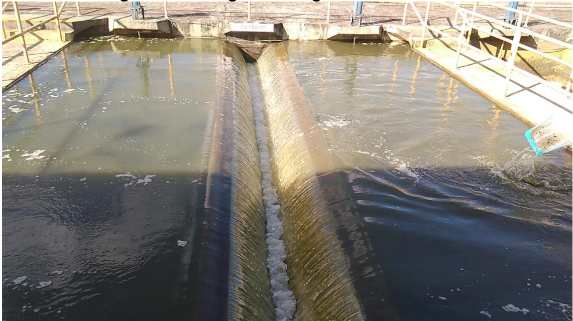
Figura 29 - Lavagem com água tratada no filtro.
