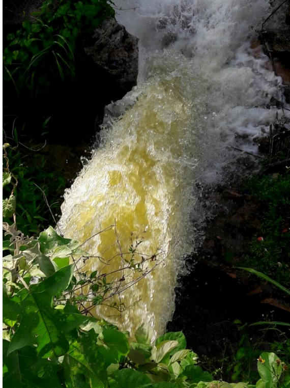
Figura 36 - Vista superior da saída de lodo da lavagem dos filtros da ETA.
