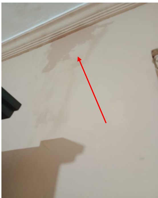
Figura 3 – Problemas de infiltração em apartamento causado devido as fissuras da Fachada
