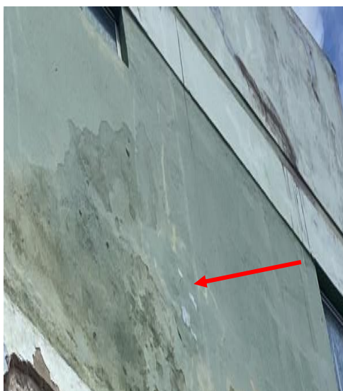
Figura 1 – Infiltrações na Fachada B
