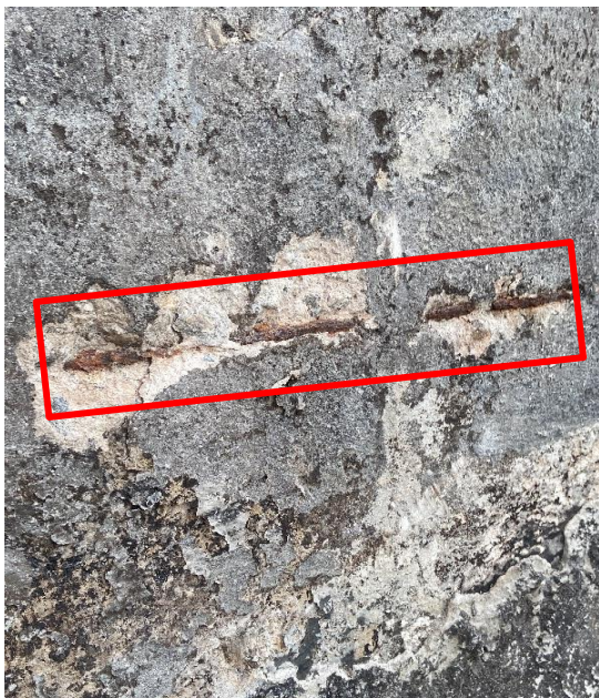
Figura 4 – Corrosão de Armadura
