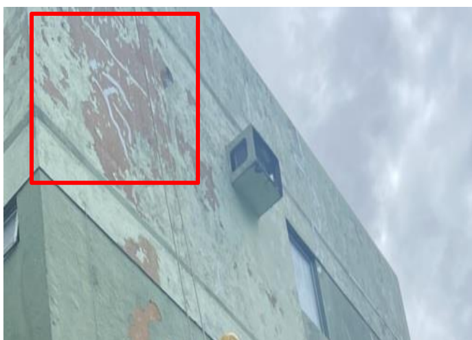
Figura 2 – Fissuras na Fachada B
