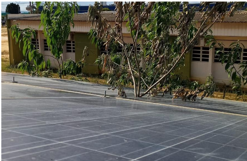
Figura 7 - Vegetação sobre painéis fotovoltaicos
