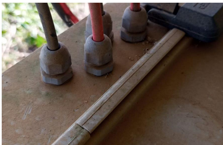
Figura 8 - Caixa de proteção coberta de sujidades
