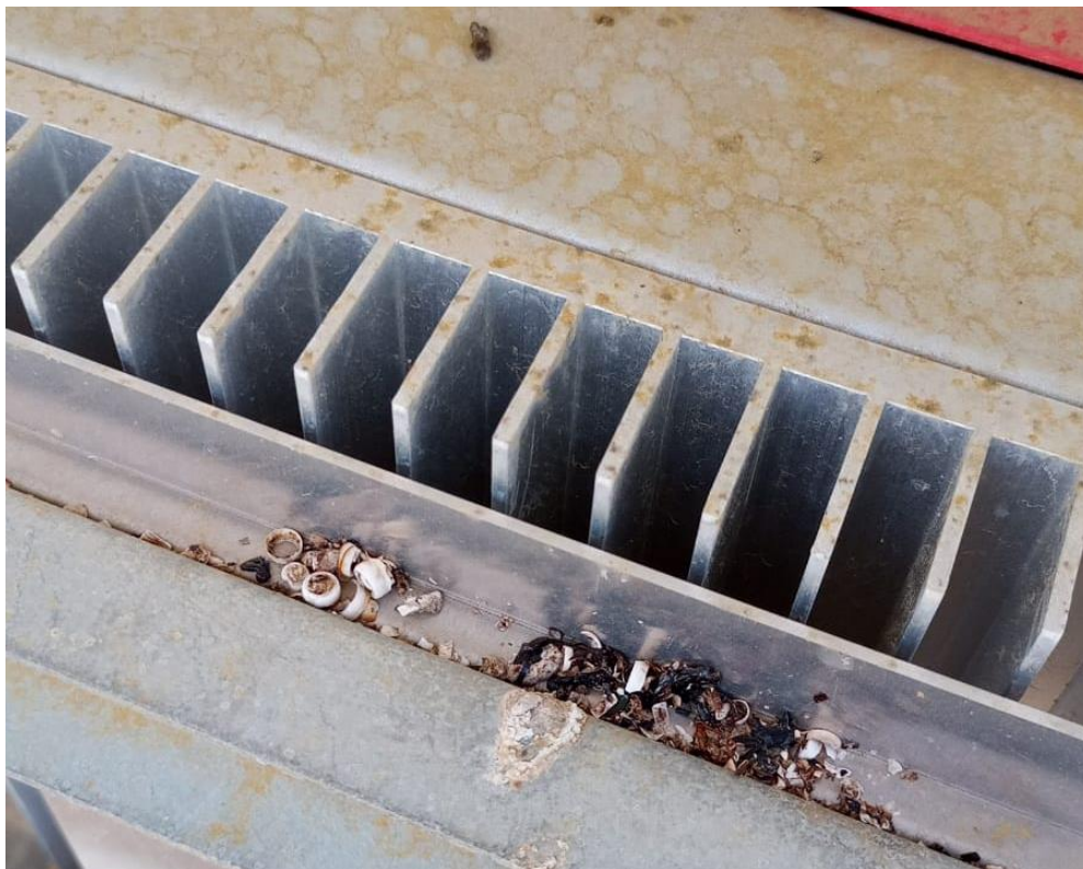
Figura 9 - Inversor coberto de sujidades
