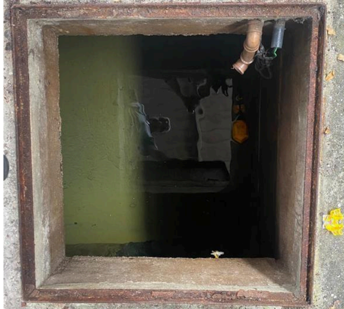
Figura 28 – Caixa separadora de água e óleo
