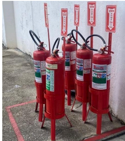
Figura 31 – Extintores de incêndio mantidos em oficinas
