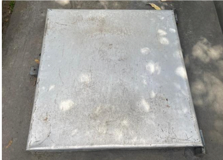
Figura 29 – Proteção da caixa separadora
